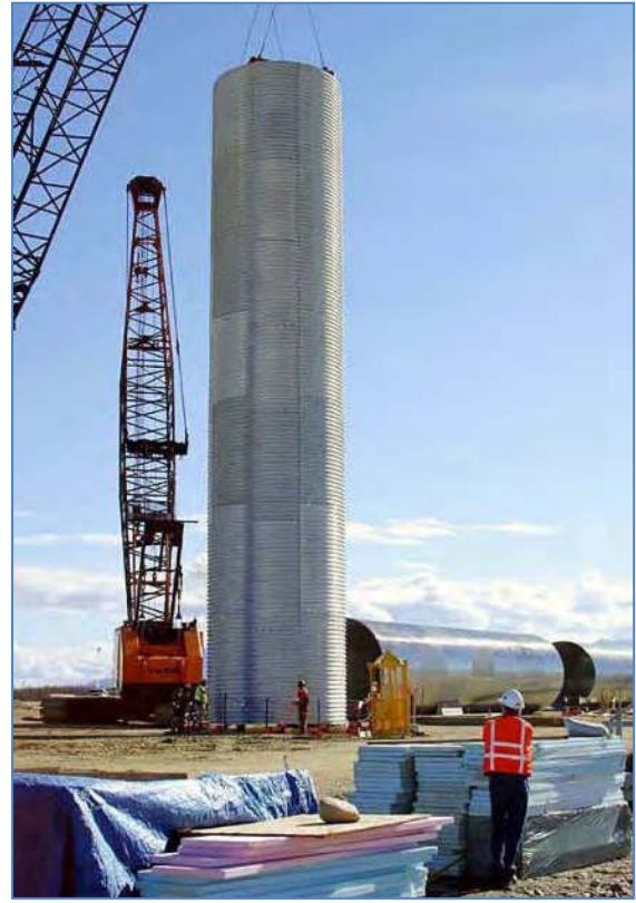
الشكل ١٠٧: بطانة مخصصة للصومعة موضوعة في المكان المحدد لتثبيتها في صومعة القذائف في مجمع إطلاق قيد البناء. (شركة بوينغ)
